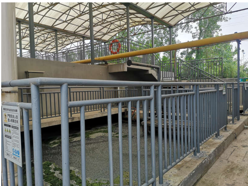
图3.2-10 生活污水处理站现场图
