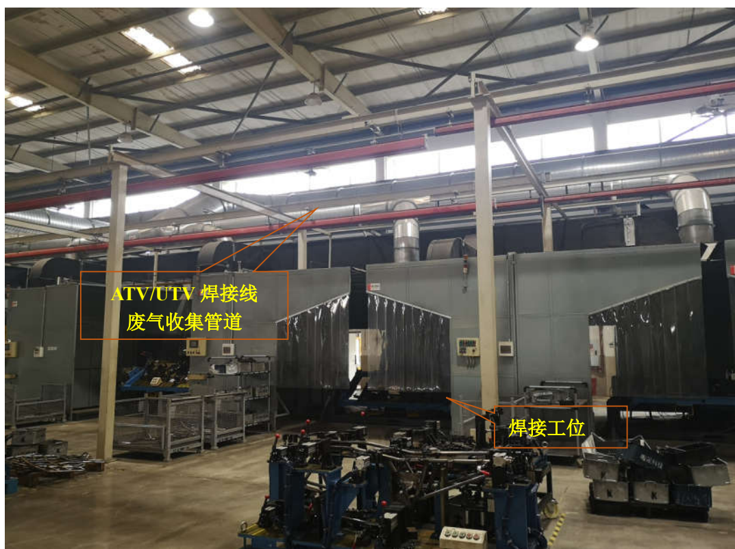
图3.2-5 ATV/UTV焊接线废气集气管道现场实景图 (FQ1、FQ2排气筒)
