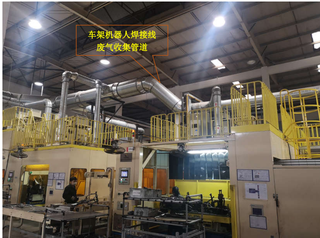
图3.2-6 车架焊接线废气集气管道现场实景图 (FQ3排气筒)
