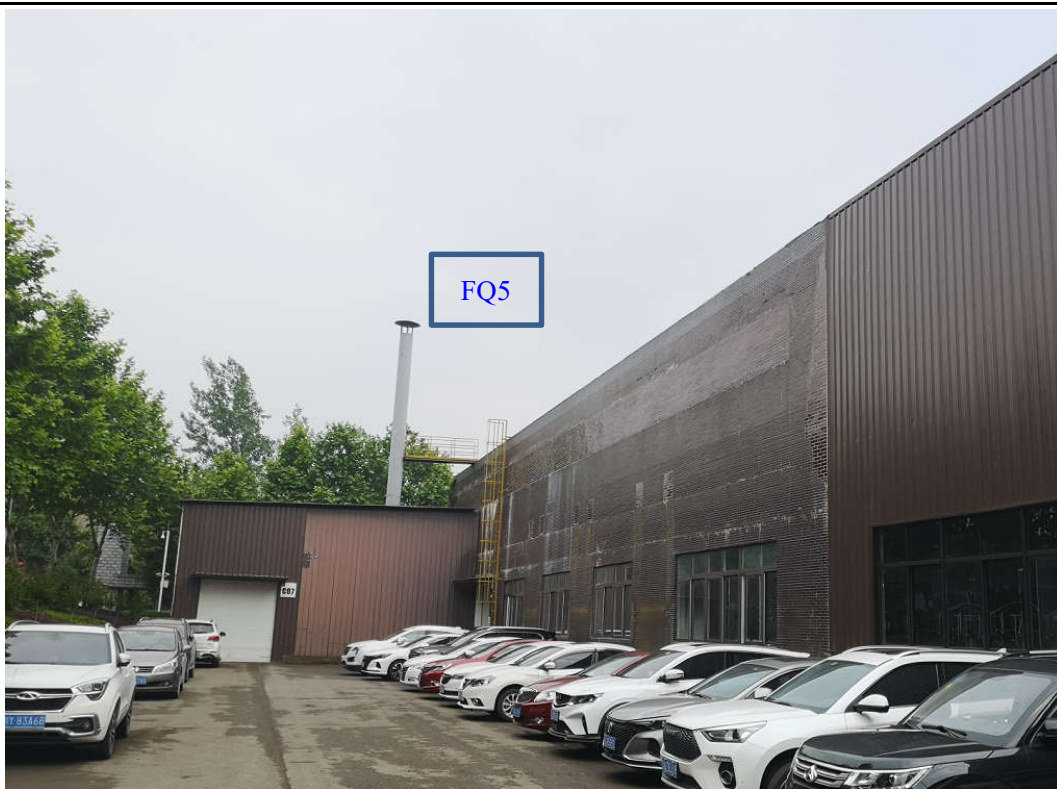
图3.2-4 废气治理设施现场实景图（FQ5）
