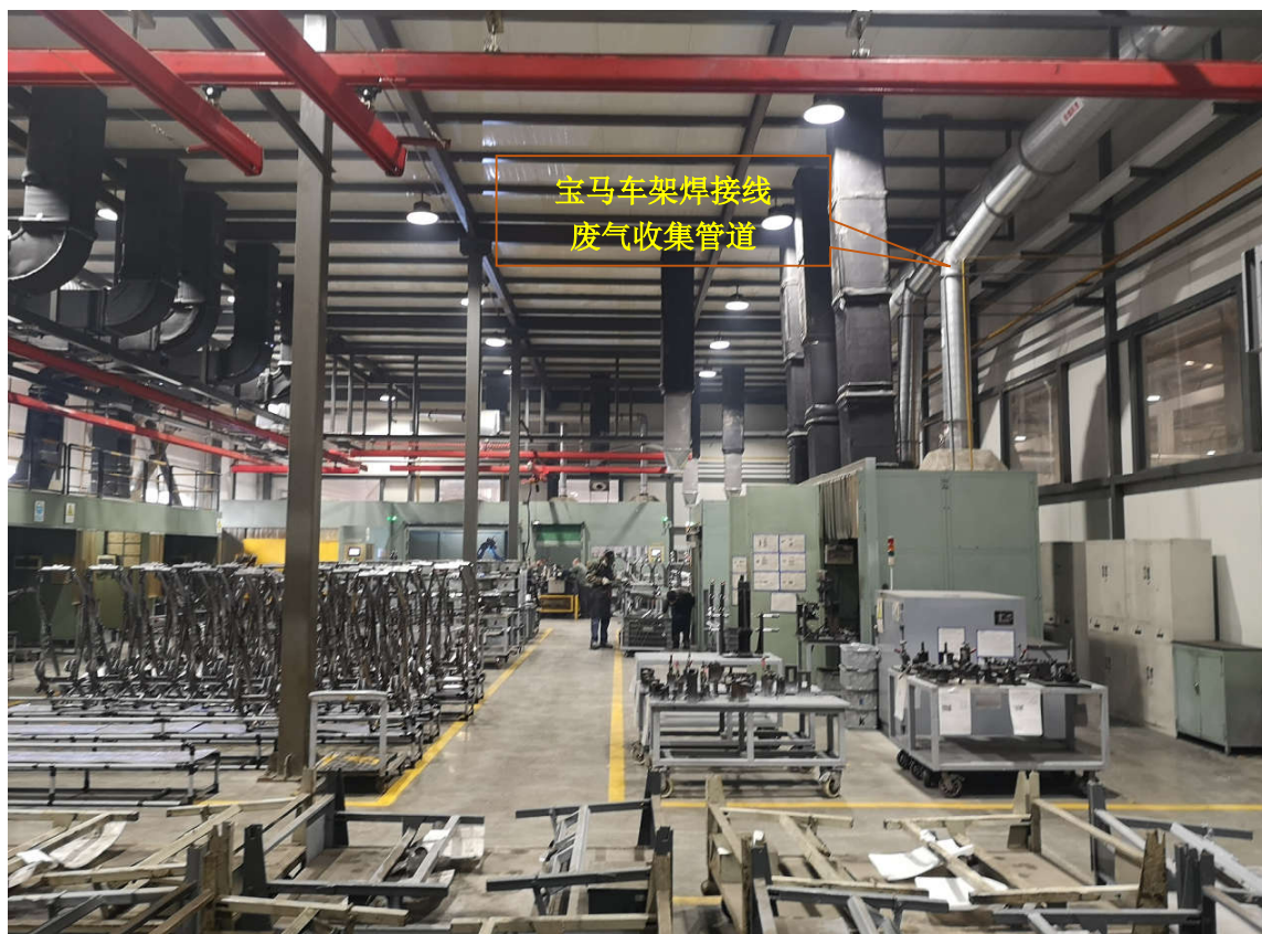
图3.2-7 宝马车架焊接线废气集气管道现场实景图 (FQ4排气筒)
